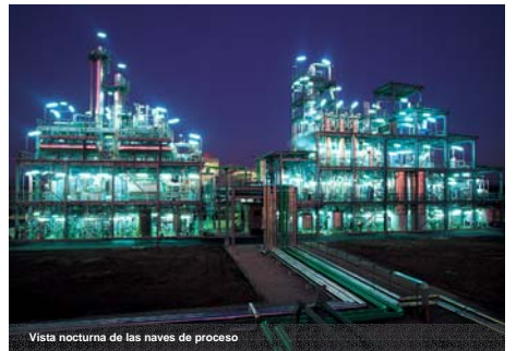
Vista nocturna de las naves de proceso
